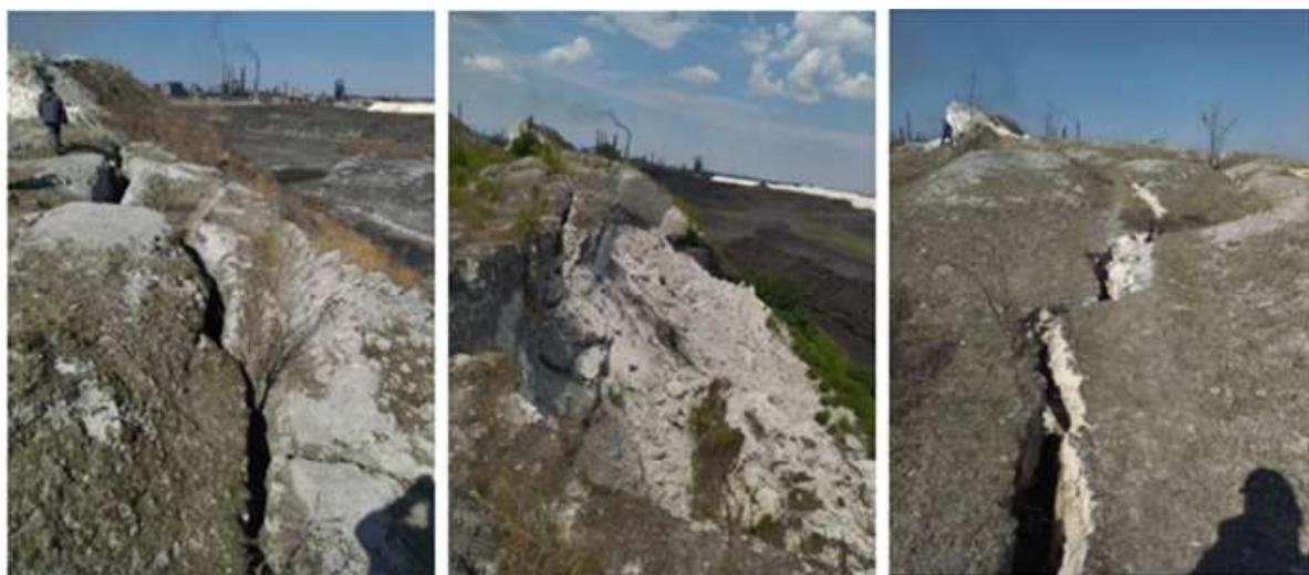
Рисунок 3.22 – Прояви небезпечних інженерно-геологічних явищ – обвали, зсуви та розтріскування потужного шару фосфогіпсу на північній дамбі хвостосховища «Дніпровське» [105, 124, 134]
