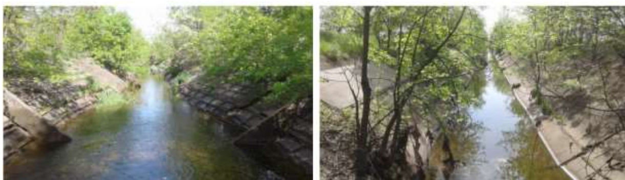
Рисунок 3.50 – Порушені ділянки протифільтраційного покриття каналу на сучасному рівні технічної експлуатації [103, 168]
